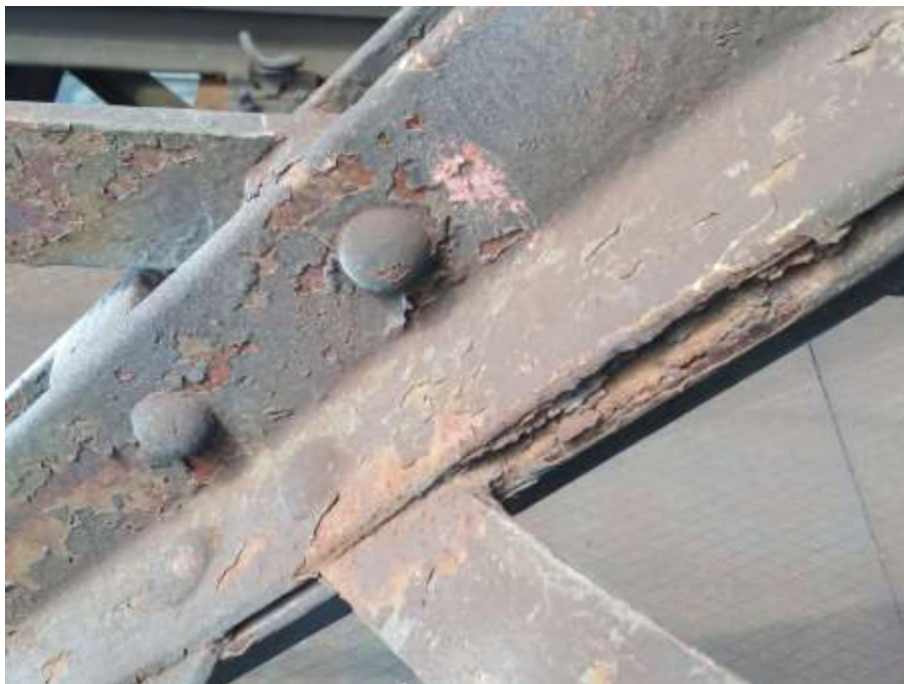
Obr. 3 Typický detail – neprůchozí štěrbina v diagonále s těžkým přístupem
