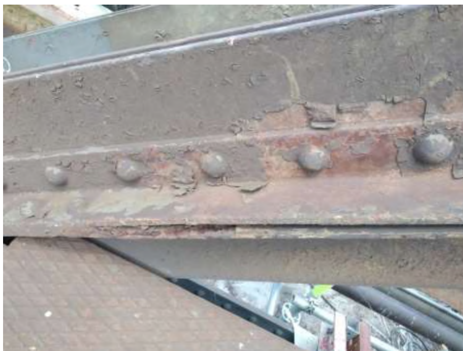
Obr. 2 Typický detail – neprůchozí štěrbina v diagonále
