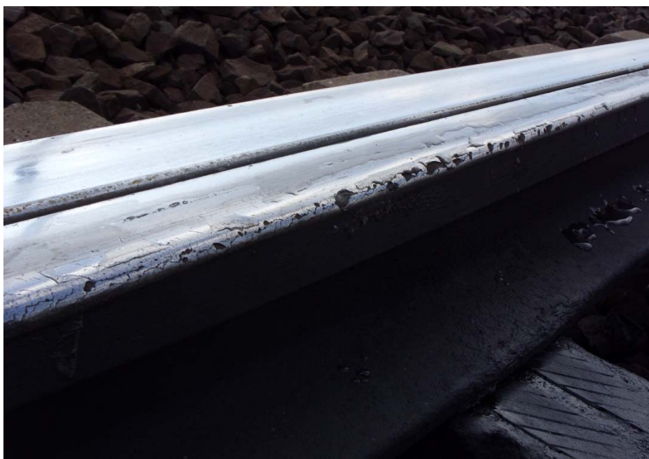
Obr. 15: Praskliny (head checking) vzniklé na temeni jazyku výhybky
