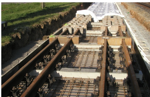
Obrázek 9: Pohled na sestavu kolejnicové splítky rozchodů 1435/1000/1520 mm
