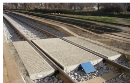
Obrázek 22: Staniční přechody SŽDC - žst. Strážnice původní a nový stav - inovované panely ÚRTR
