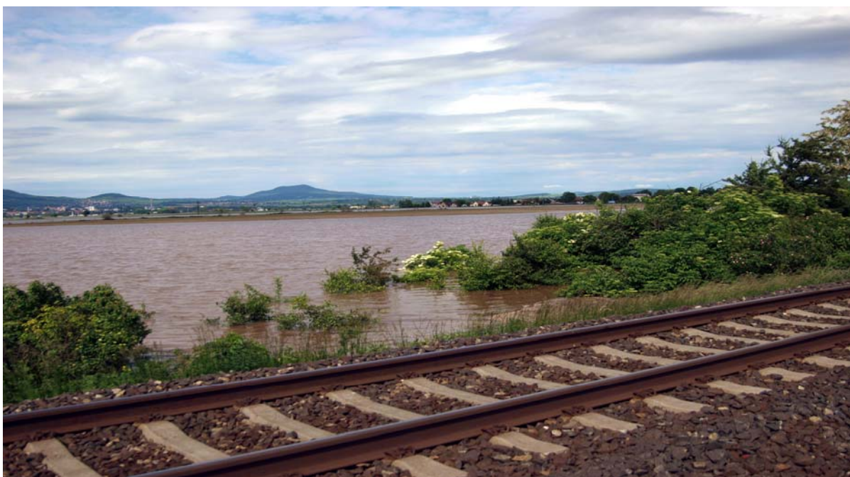
Obr. 1: Traťová kolej dotčená povodní
