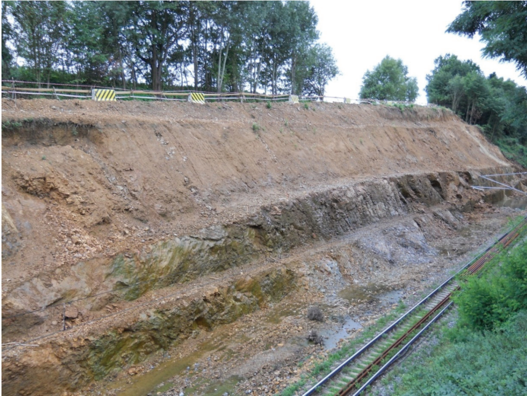
Obr. 2 Výchozí stav před sanací Střelítovského zářezu, na snímku jsou zřejmé sesuvy svahů a značný přítok vody i v suchém období
