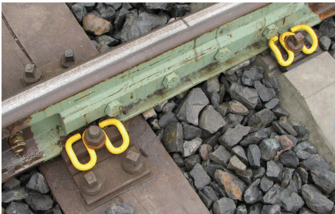
Obr. 4 Vlevo svěrka Skl 1K nesprávně použitá na žebrové podkladnici Vpravo správně použitá svěrka Skl 1K u LIS v soustavě S 49
