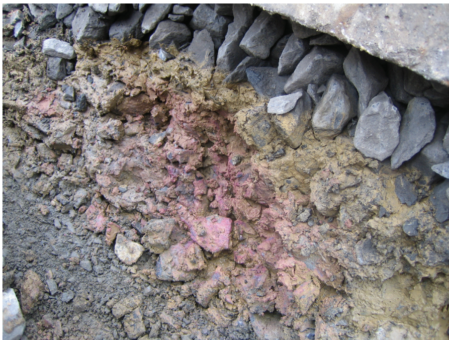
Stav kolejového lože
