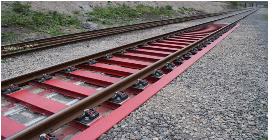
Obr. 2 Pevná jízdní dráha s blokovou kolejnicí (Balfour Beatty) a nová ocelová konstrukce jízdní dráhy firmy Corus Rail
