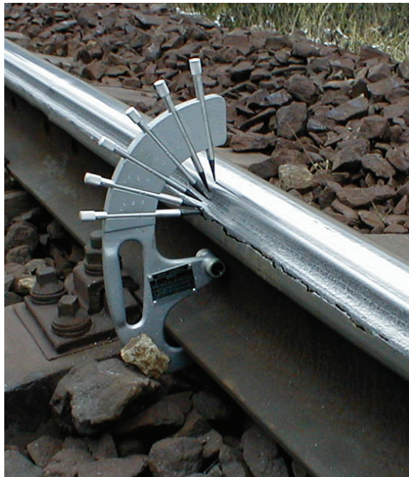
Obr. 1 Opotřebení kolejnic je v úseku významné, vyžaduje pečlivé sledování. (TÚ Ústí nad Orlicí – Brandýs nad Orlicí km 262,265, červenec 2005)
