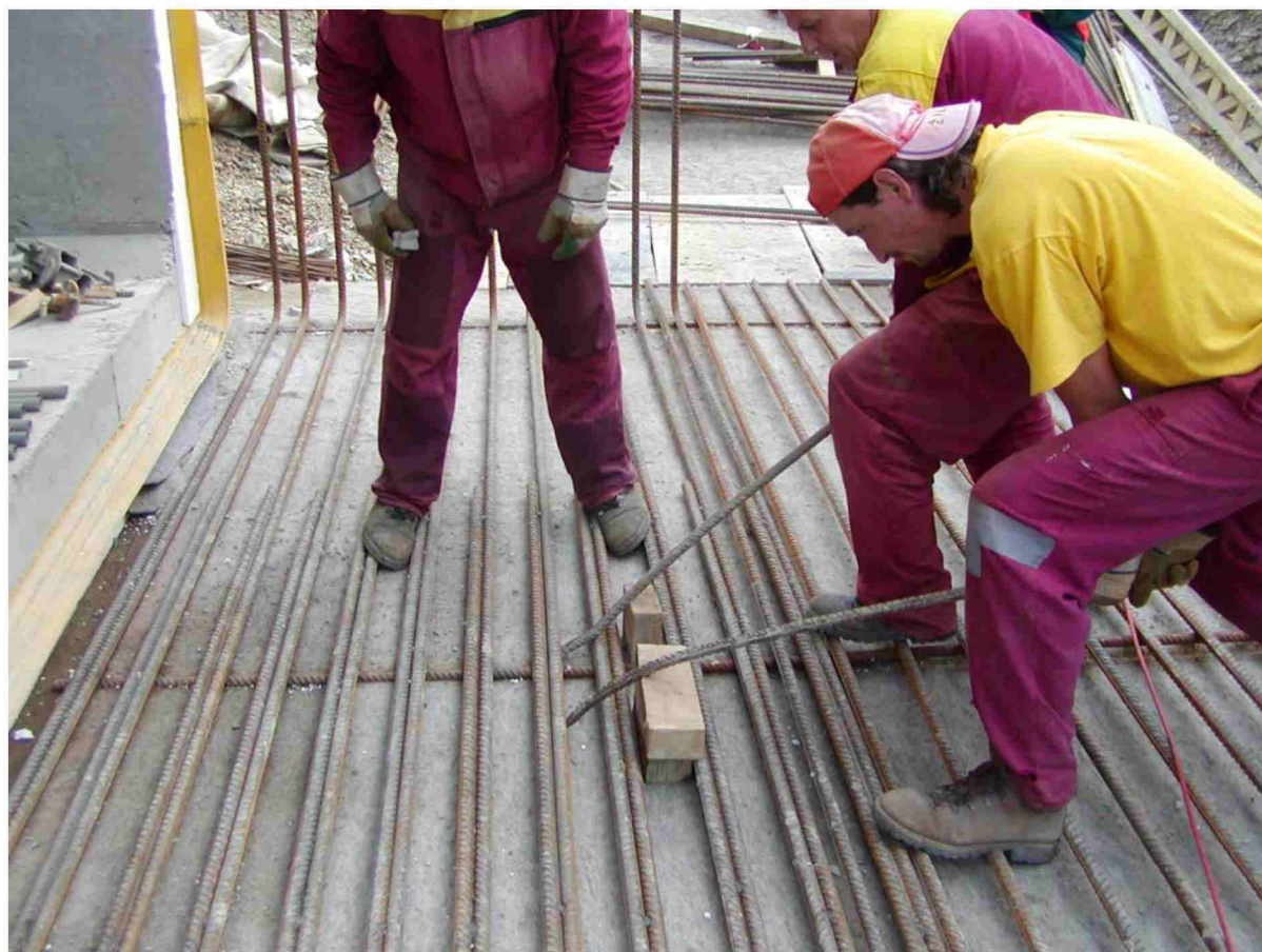
Poškození SVI při armování
